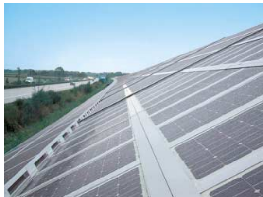
Abb. 69: Eine Photovoltaikanlage auf der Lärmschutzwand erzeugt Strom
