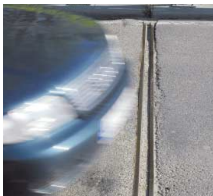
Abb. 34: So bitte nicht: lauter Fahrbahnübergang
